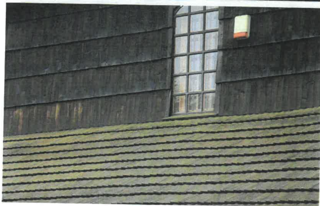
Fot. nr 9 i 10. Kościół parafialny pw. Świętego Stanisława BM w Skrzyszowie. Stan przed konserwacją.
