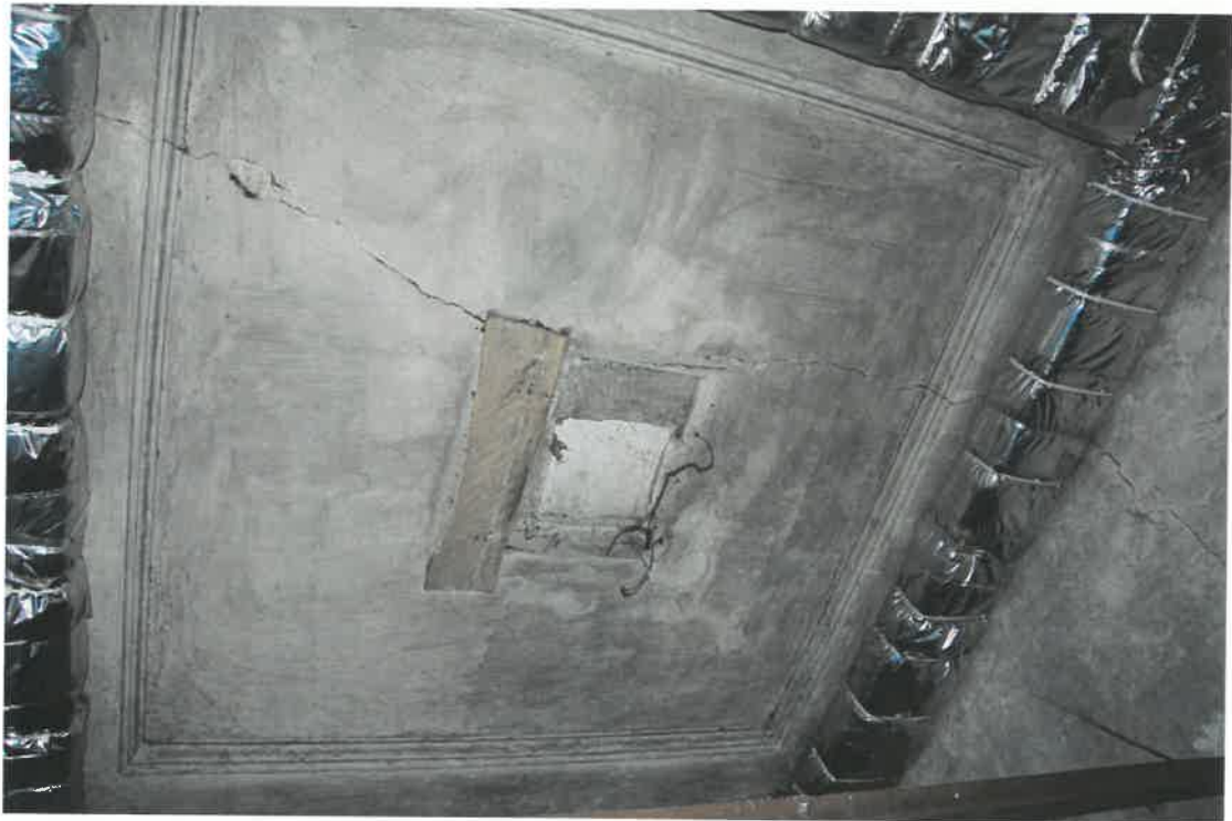
Fot. Nr 6 i 7. Kościół p.w. NMP Szkaplerznej w Szywnawaldzie. Stan przed konserwacją.
